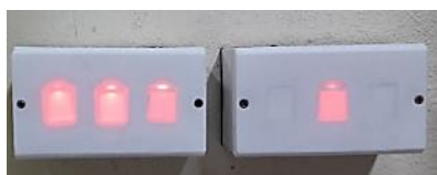
(ข) กล่องชุดควบคุมที่ติดตั้งใหม่ รูปที่ 11 การติดตั้งใช้งานชุดควบคุม
