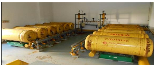
รูปที่ 2 ห้องเก็บถังแก๊สคลอรีน
