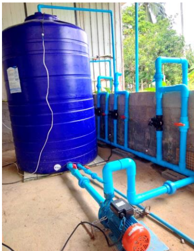
รูปที่ 5 ถังน้ำ ปั๊มน้ำ และท่อส่งน้ำที่ติดตั้งโซลินอยด์วาล์ว ขนาด 1.5 นิ้ว 24VAC ในระบบจ่ายน้ำแบบอัตโนมัติ
