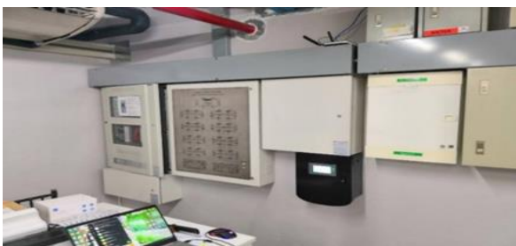
รูปที่ 4 ระบบตรวจติดตามการทำงานของระบบแจ้งเตือนเหตุเพลิงไหม้ผ่านระบบ IoT
